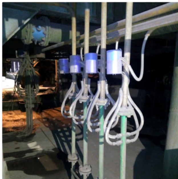
Рис. 1/3 Расходомеры-счетчики IPKA, установленные в системе охлаждения Доменной печи №4 на трубах Ду32 ПАО «Запорожсталь»
