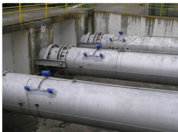
Рис. 1/4 Расходомеры-счетчики IPKA, установленные на «Малых насосных станциях орошения УГКМК». Диаметры труб от 200 до 800 мм
